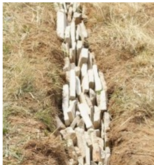
Drain d'infiltration (photo : Benjamin Broustey)
