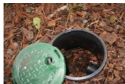
Regard d'irrigation (photo : Greywater Action)
